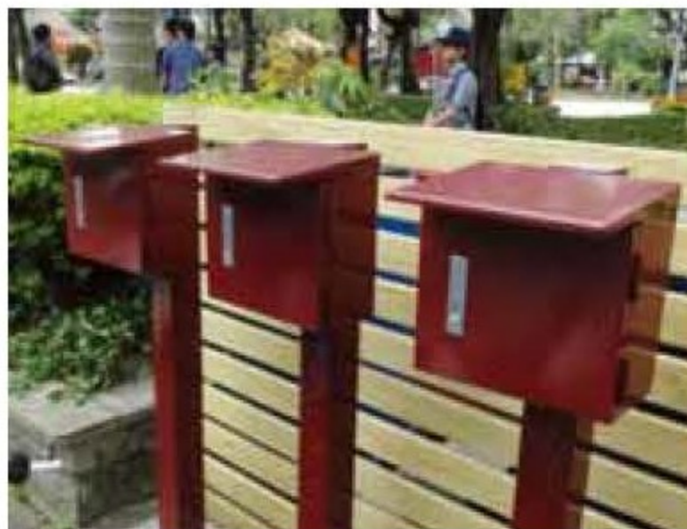
電動機車充電站
